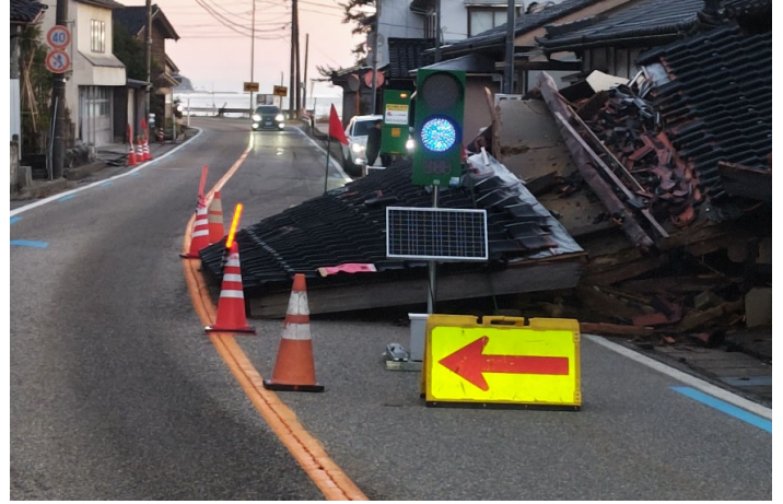
倒壊家屋が道路を塞ぎ、片側交互通行にて対応
