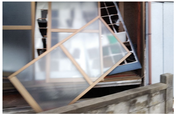
崩れ落ちるブロック塀
